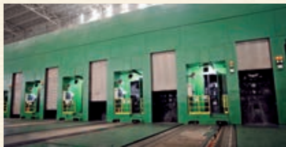
酸洗・5基連続冷間圧延一貫ライン
